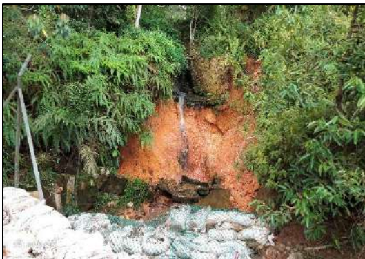
Penjara Kluang, Johor - Runtuhan Tanah di Rumah Pam (09.09.2021)
