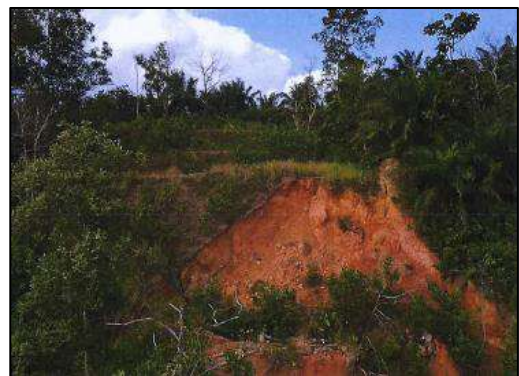
Penjara Kluang, Johor - Runtuhan Tanah di Lereng Bukit (09.09.2021)
