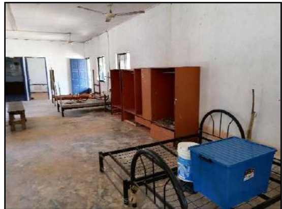
Kelengkapan Perabot Tidak Mencukupi Lokasi: Pos Wallace Bay Tawau, Sabah Tarikh: 20.11.2019
