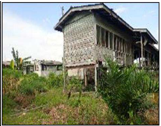
Kwarters Telah Rosak dan Tidak Boleh Diduduki (Dibina Pada Tahun 1968) Lokasi: Batalion 10 PGA Sibu, Sarawak Tarikh: 13.11.2019
