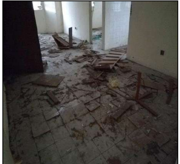
Kerosakan Lantai Jubin Kuarters Lokasi: Batalion 17 PGA Lahad Datu, Sabah Tarikh: 19.11.2019
