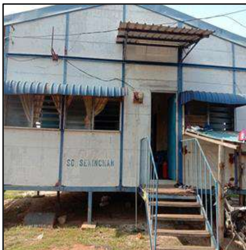
Pos Kawalan Tidak Dilengkapi Pagar, Lampu Spotlight, Bangka dan Bilik Kebal Senjata Lokasi: Pos JPG Sekinchan Sabak Bernam, Selangor Tarikh: 04.02.2020
