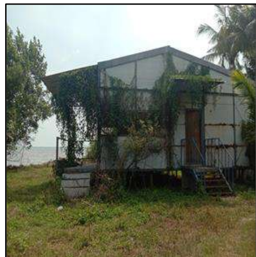
Pos Kawalan Tidak Dilengkapi Pagar, Lampu Spotlight, Bangka dan Bilik Kebal Senjata Lokasi: Pos JPG Ladang Tumbuk Kuala Langat, Selangor Tarikh: 05.02.2020
